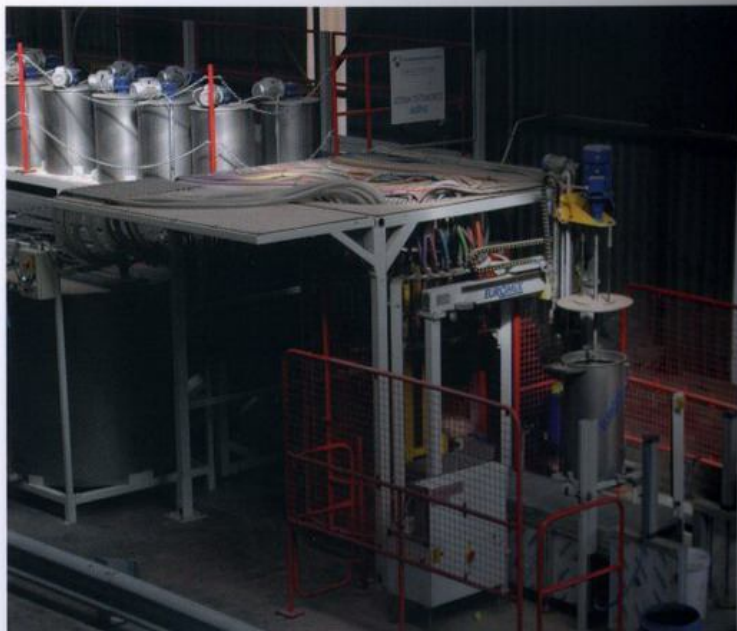
Sistema automatico di dosaggio di Euromeccanica S.r.l.
